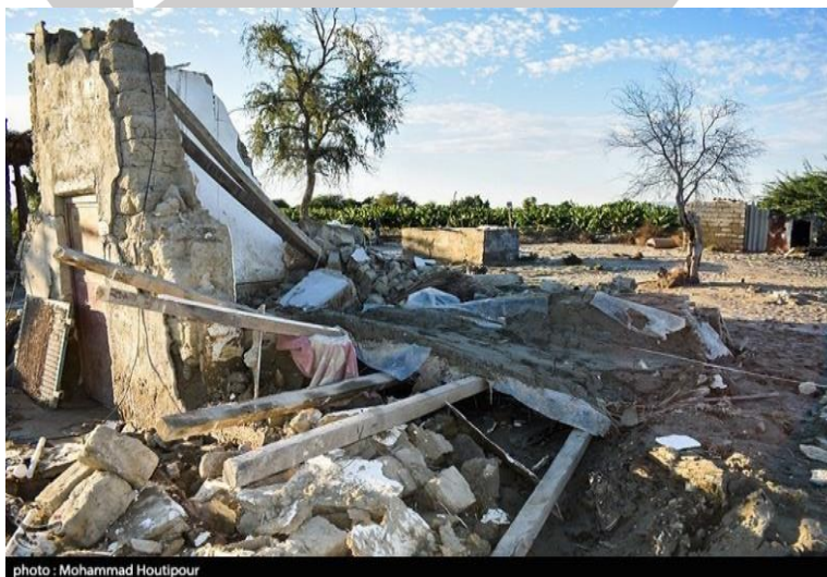
شکل ۳-۱۳: تخریب خانه روستایی در منطقه سیل‌زده استان سیستان و بلوچستان
