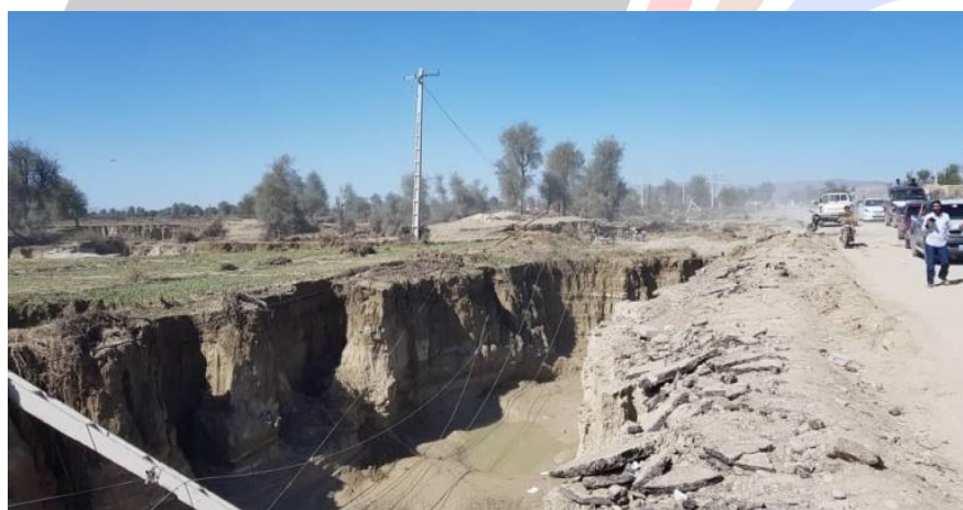
شکل ۳-۱۵: قطع برق در مناطق روستایی منطقه سیل زده در استان سیستان و بلوچستان در اثر واژگونی تیرهای برق
