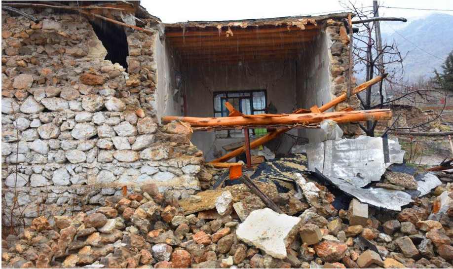
شکل (۱۰): ریزش دیوارهای سنگی پیرامونی و عدم اتصال مناسب سقف به دیوارها
