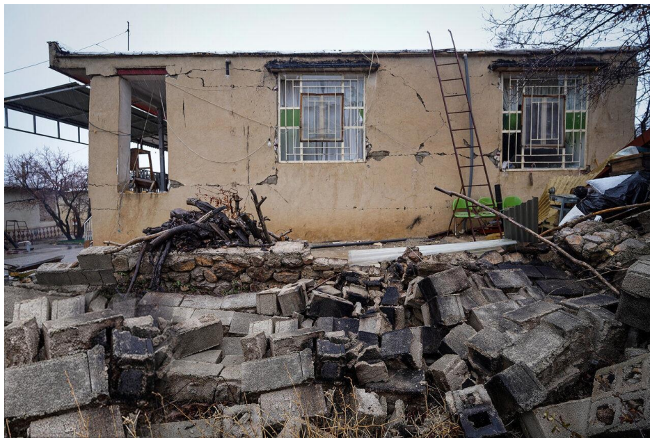
شکل (۱۱): ریزش دیوار پیرامونی به علت عدم تامین کشش در ملاتھا
