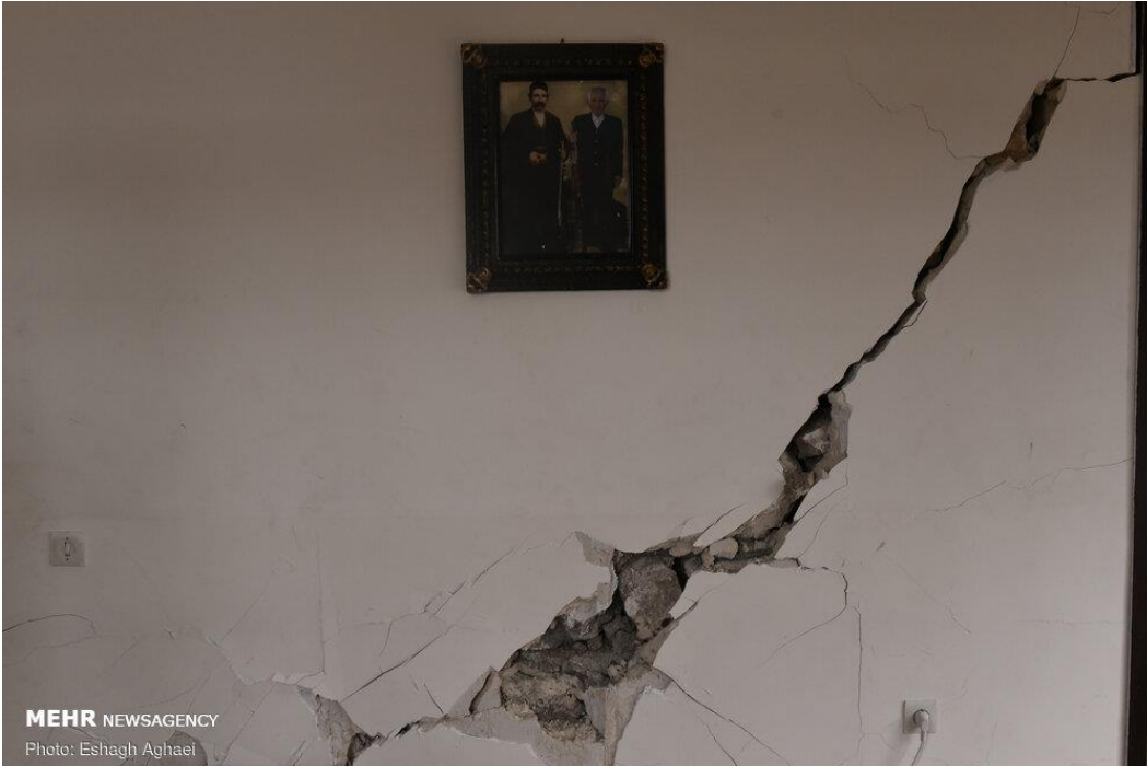
شکل (۶)-ادامه: ایجاد ترکهای مورب در دیوارهای داخلی
