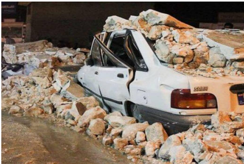
شکل (۸): ریزش دیوار و آسیب به وسایل نقلیه مجاور
