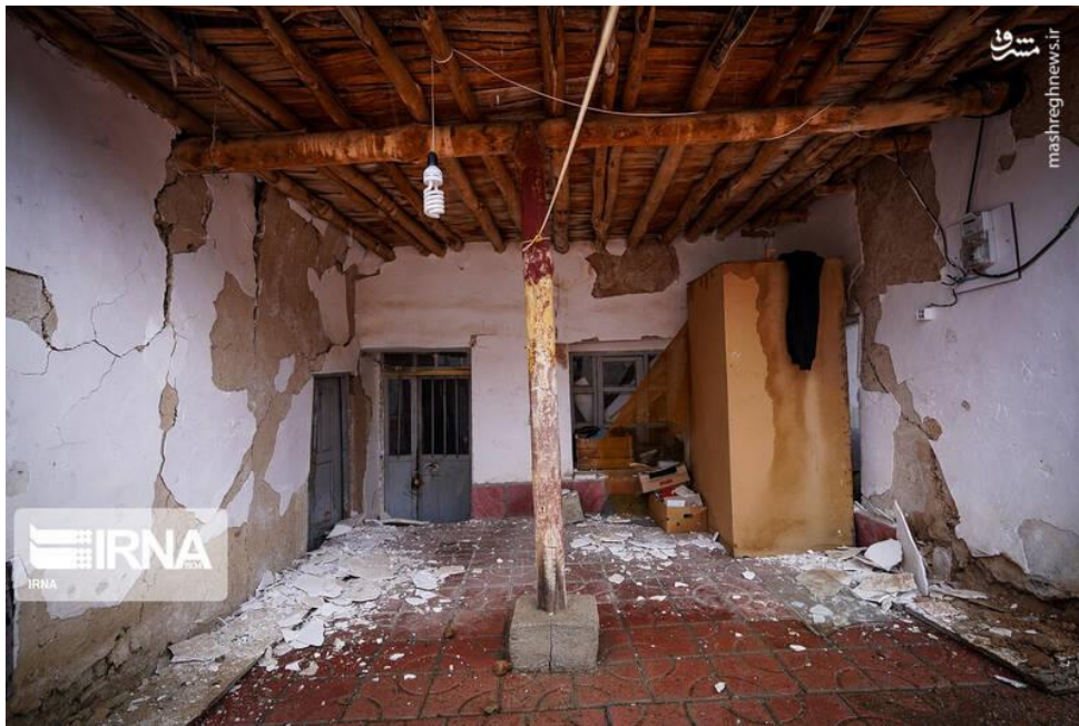
شکل (۶): ایجاد ترکهای مورب و قطری در دیوارهای ساختمانهای با مصالح بنایی
