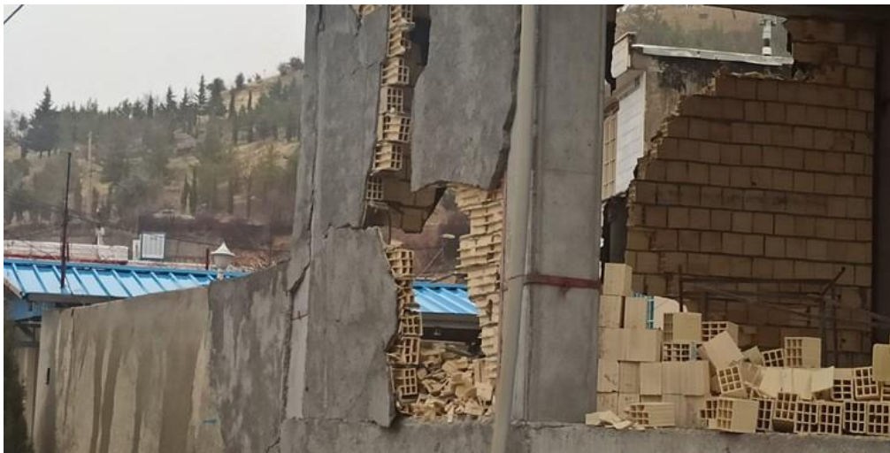
شکل (۱۲): عدم اجرای وال پست و دیوار چینی نامناسب در میانقابها
