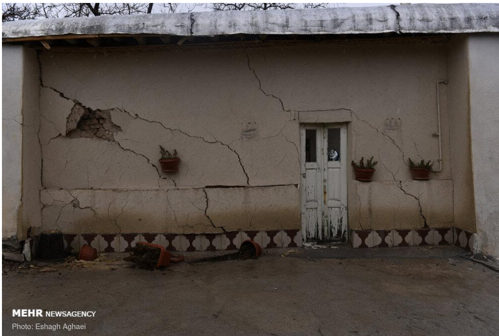
شکل (۶)-ادامه: ایجاد ترکهای مورب در دیوارهای پیرامونی ساختمانهای با مصالح بنایی
