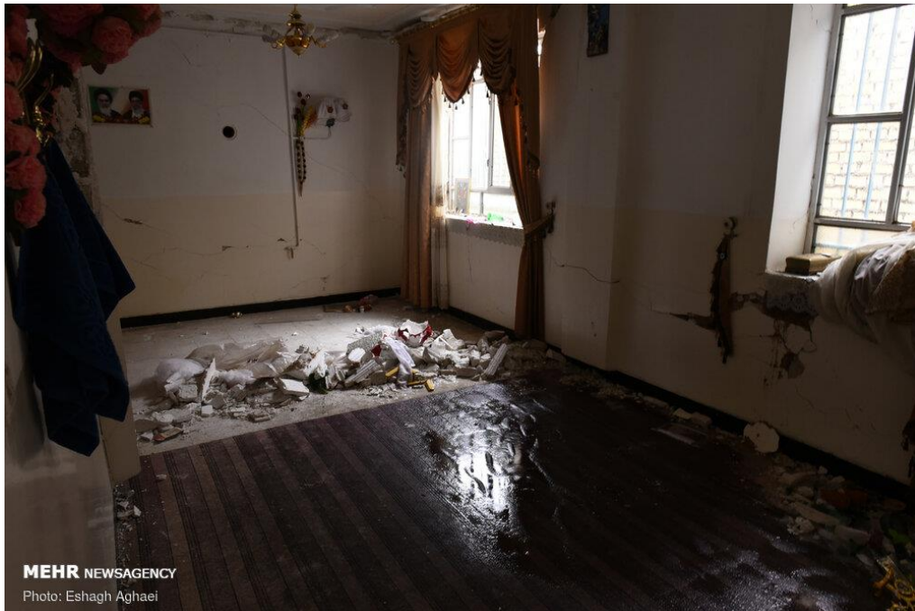
شکل (۷): ترک خوردگی اطراف بازشوها و جدا شدن پنجره به دلیل عدم اتصال مناسب
