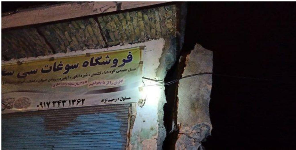
شکل (۹): ترک مورب و افقی در دیوار و جدا شدگی دیوار از قاب
